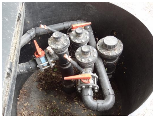
Abbildung 25: Gasbrunnen 3.11 mit drei Entgasungsrohren und einem Sickerwasserförderrohr (DA I)
